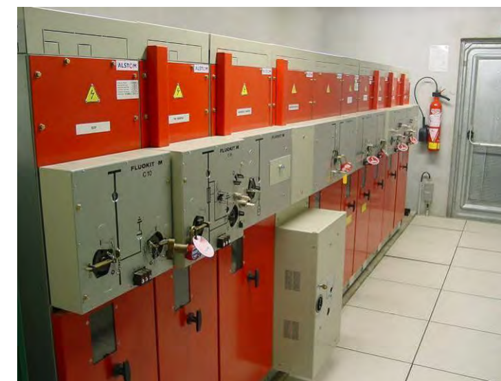
Figure 221 : Intérieur d'un poste de livraison
