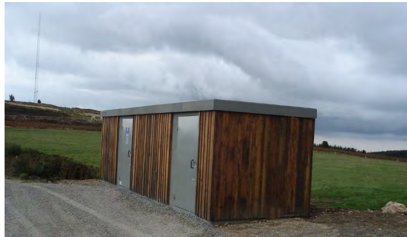
Figure 223 : Poste de livraison du parc éolien du MARGNES (81)
